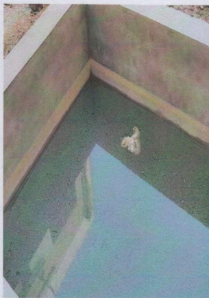
1#: 皂化渣库渗滤液出口
